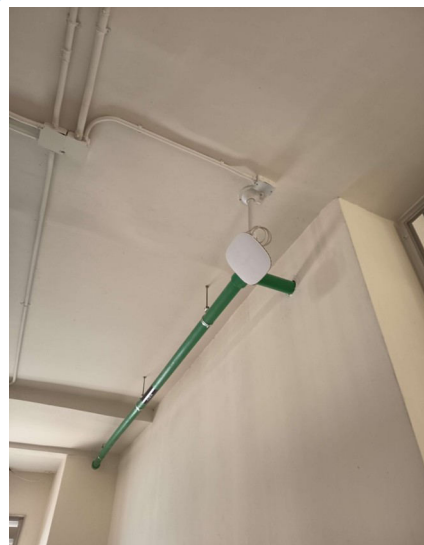
Anchor มุมอาคาร พร้อมท่อร้อยสาย
